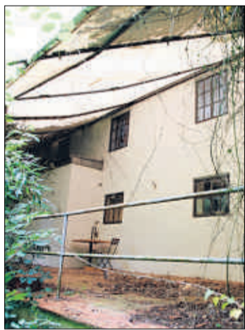
Teilweise ist das Gebäude in einem desolaten Zustand.
